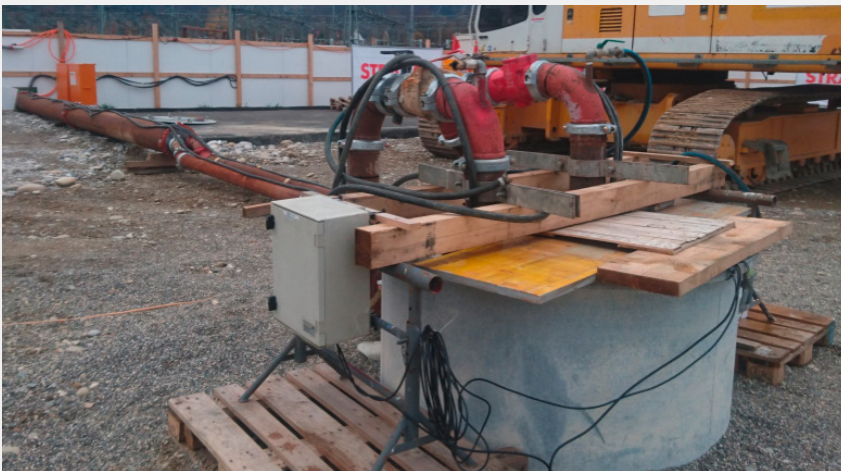
Fig. 13 Pumpversuchseinrichtung mit Förderleistung 10 000 l/min.
